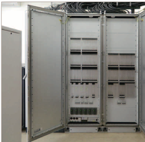
• Фото № 1 Управляющий вычислительный комплекс МПЦ-2
