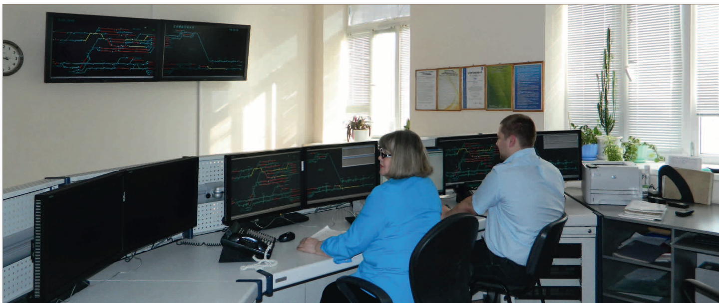
• Фото № 3 Работа МПЦ-2 на станции Слябовая
